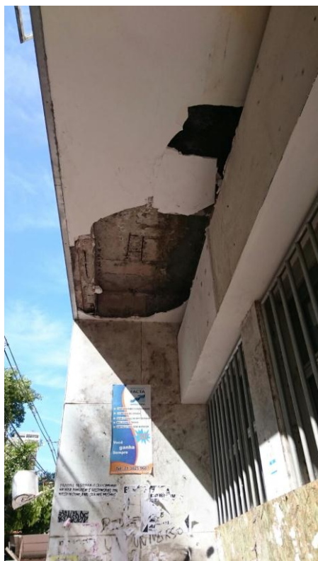
Forro da marquise tombado
