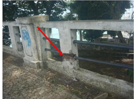
Barra de proteção rompida
