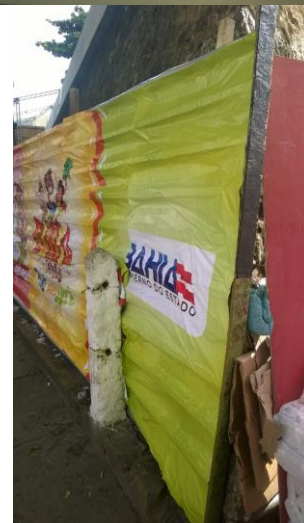
Isolamento do tapume metálico camarote com saliência, causando risco de acidente.
