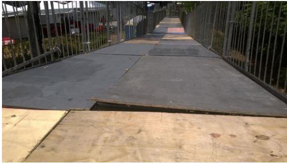
Piso instável de rampa de acesso
