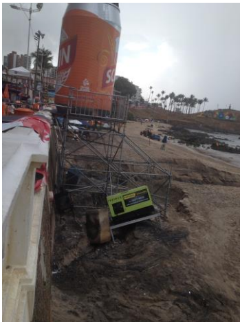
Publicidade da Schin, ameaçado de desabamento depois das chuvas.
