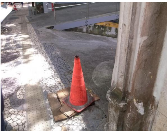
Caixa do registro de água sem tampa
