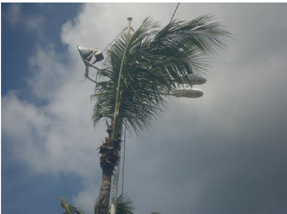
Palhas de coqueiro sobre luminárias
