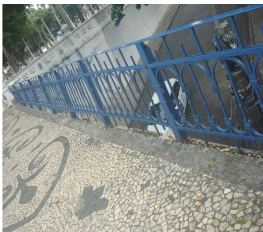
Grade de proteção completamente solta
