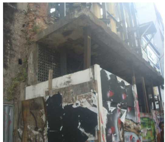
Fachada com risco de desprendimento
