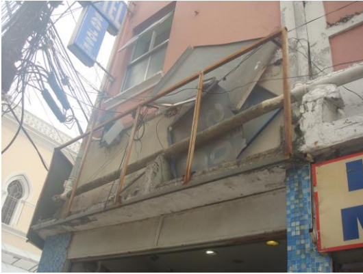
Letreiro danificado com risco de queda
