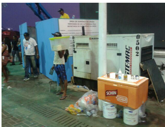
Gerador do Posto da Salpur Barra Center, sem isolamento
