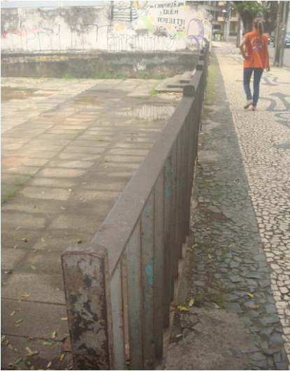
Trecho da grade solta
