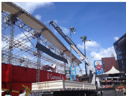
Isolamento do camarote da Brahma / Operação de desmonte da estrutura do camarote da Brahma
