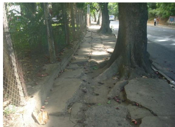
Calçamento em placas de concreto danificado
