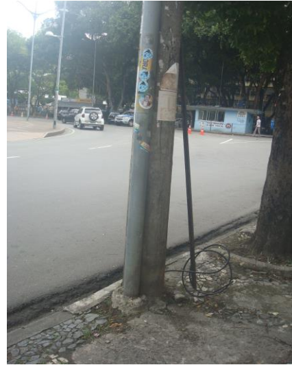
Cabo de aterramento solto
