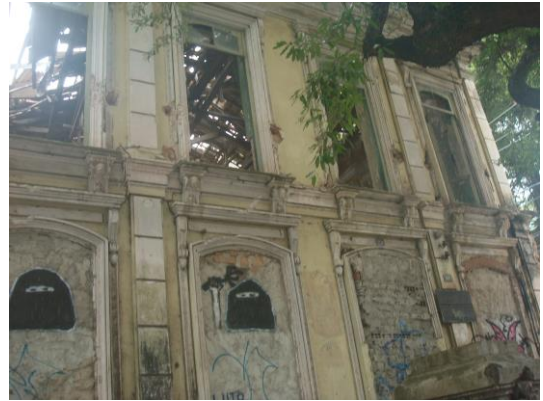
Casarão em ruínas
