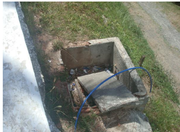
Caixa de subestação da Embasa c/ tampa danificada
