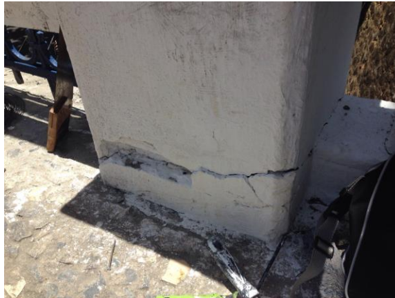
Pilar seccionado com risco de desabamento no viaduto da Gamboa
