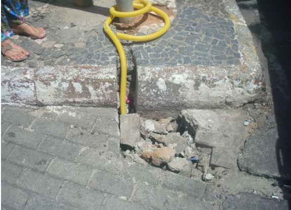
Cabo Envolvido no Poste e Rompido
