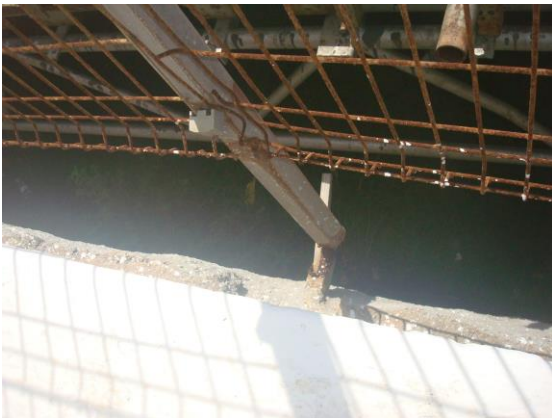
Grade de proteção pendente com fixação oxidada
