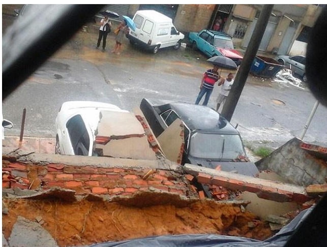
Muro desaba em Cajazeiras V na manhã deste sábado (9), em Salvador (Foto: Arquivo pessoal)
